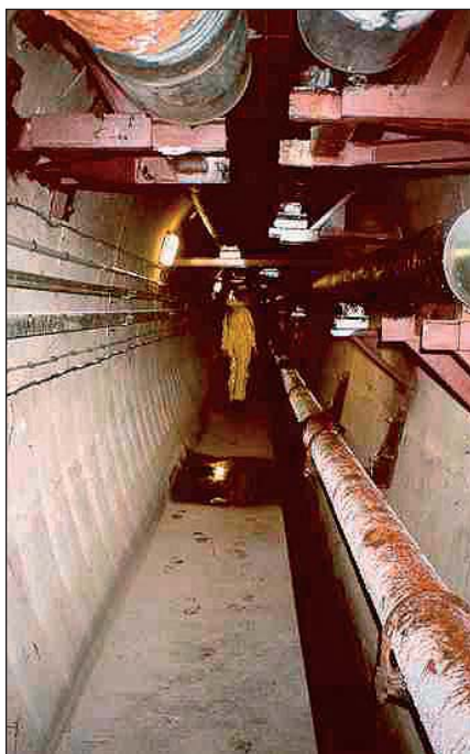
Photo 1 Galerie multiréseaux rue de Picardie Multiple-network gallery on Rue de Picardie
